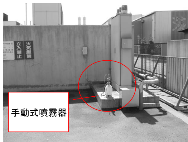
写真 6 加工卵工場 出入口付近（消毒器）
