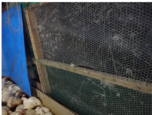
<鶏舎側面の網の破損>
