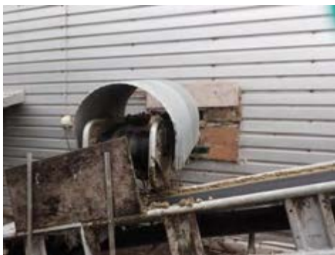
※除糞ベルトを外側から撮影
