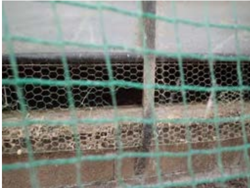
※南側側面に金網の破損 (直径約10cm)
