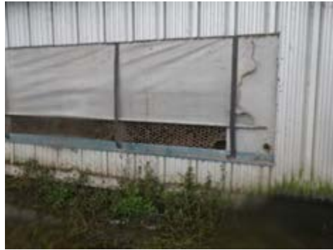
<発生鶏舎側面の金網の破れ>
