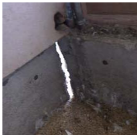
<発生家きん舎の基礎部の割れ目>
