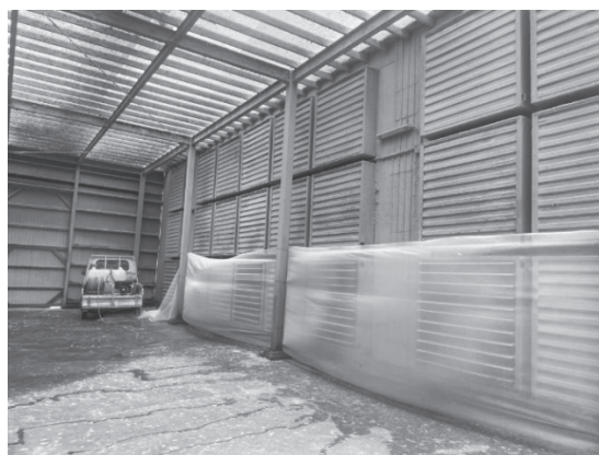
(写真4) 鶏舎の排気口に取り付けた不織布消毒薬をしみこませるための動力噴霧器を車載（奥の軽トラック）
