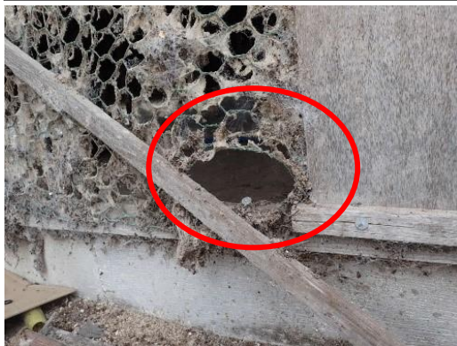
金網や防鳥ネット等の 破損
