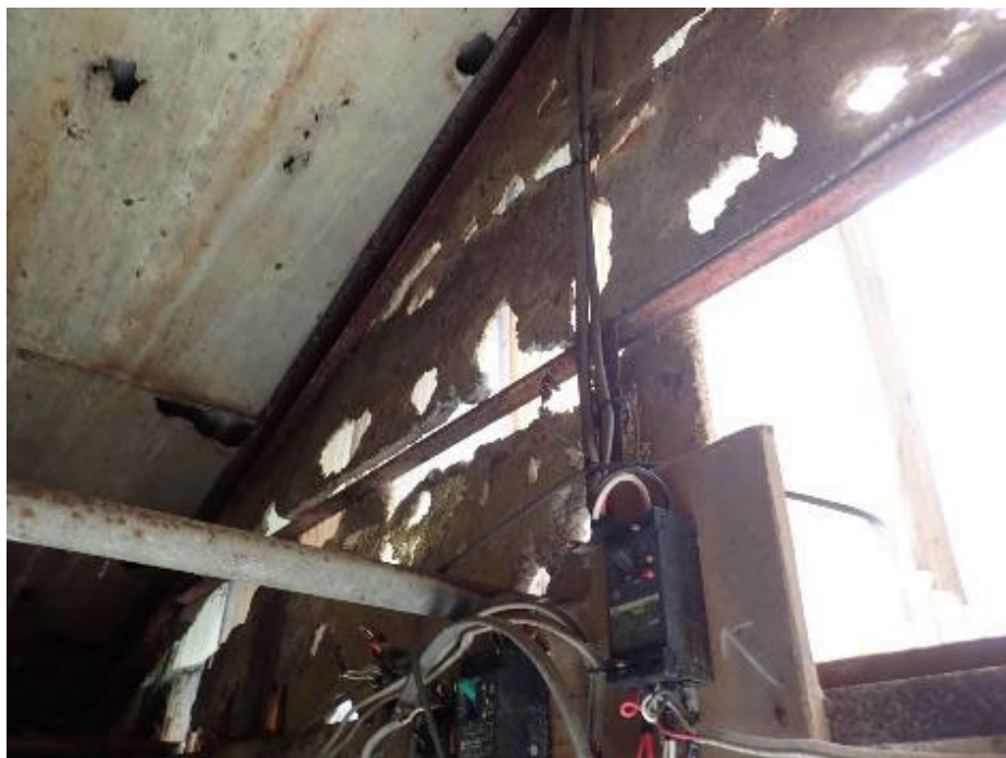
豚舎壁面の破損部
