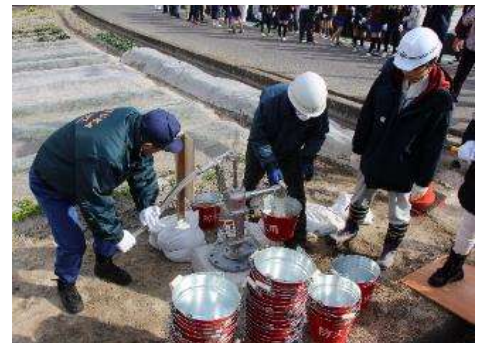
防災兼用井戸の整備
