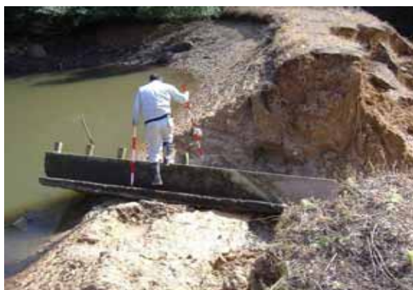
決壊に伴い壊れた取水施設(平田池)
