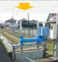
水門開閉の電動化
