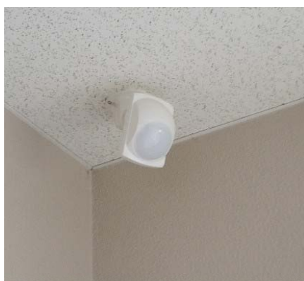
侵入監視用センサー
