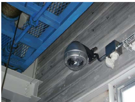
綾戸取水口屋内カメラ
