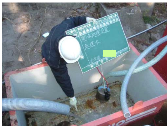
濁水処理後の状況
