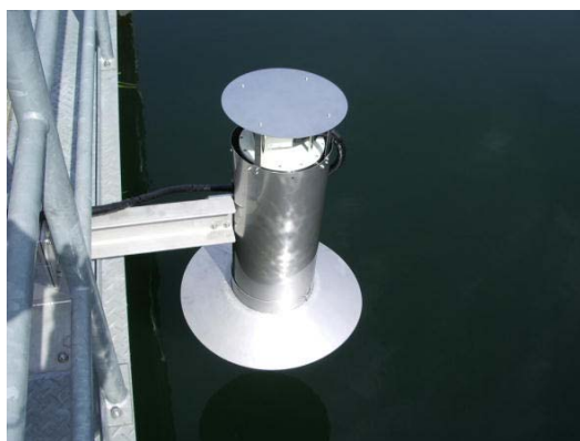
改築後の設備（油膜検知機）
