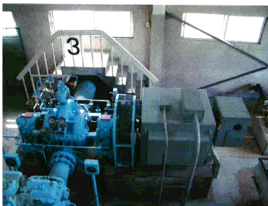
改築前のポンプ設備（東部第一揚水機場）
