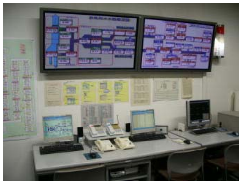
改築後の設備（状況表示装置）
