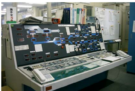
改築前の設備（操作卓）
