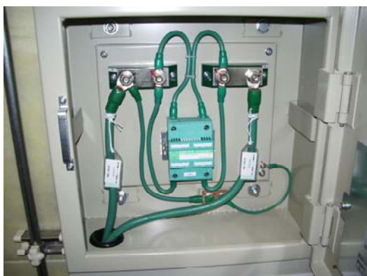
改築後の設備（雷害対策用設備）
