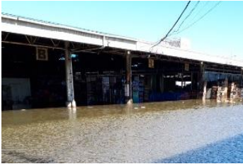
大雨による浸水被害 (荷捌場)
