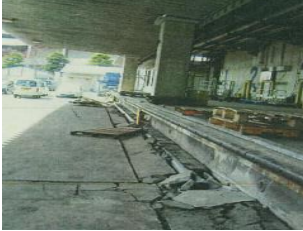
地震による施設被害
