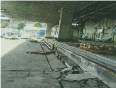
地震による施設被害
