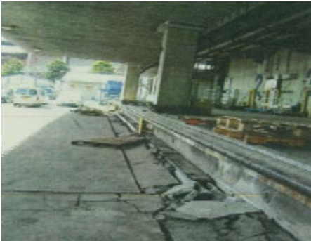
地震による施設被害
