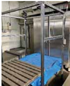
立体予冷库(搬入口)
