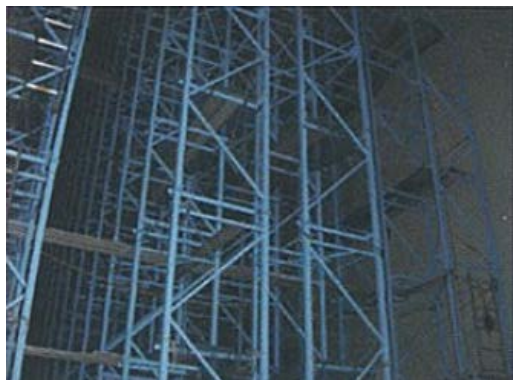
(自動倉庫設備)
