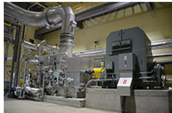
タービンと発電機
