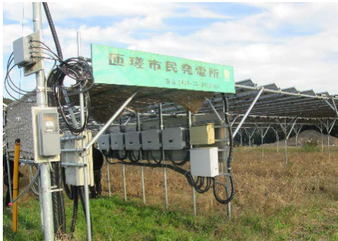
「市民発電所」の看板掲示
