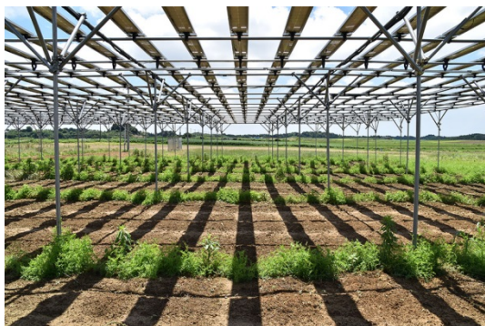
発電設備の外観
