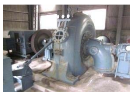
富士緒井路第一発電所 (富士緒井路土地改良区) 最大発電出力=380(kW) 運転開始年: 1914年 水車形式: 横軸フランシス式
