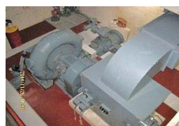
長谷緒井路発電所 (長谷緒井路土地改良区) 最大発電出力=1,300(kW) 運転開始年: 1991年 水車形式: 横軸フランシス式
