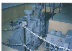
大野原発電所 (大野町土地改良区) 最大発電出力=260(kW) 運転開始年: 1987年 水車形式: 2射形ペルトン式
