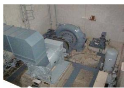
富士緒井路第二発電所 (富士緒井路土地改良区) 最大発電出力=1,500(kW) 運転開始年: 1984年 水車形式: 横軸フランシス式
