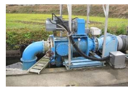
城原井路発電所 (城原井路土地改良区) 最大発電出力=25(kW) 運転開始年: 2010年 水車形式: プロペラ式
