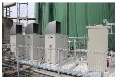
バイオガス発電機
