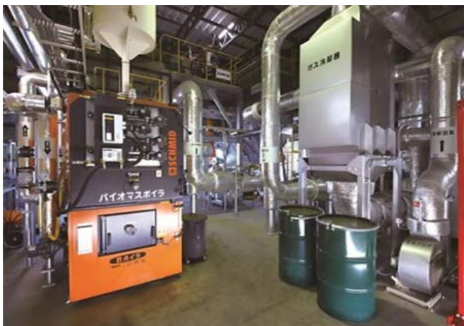
木質バイオマスボイラ
