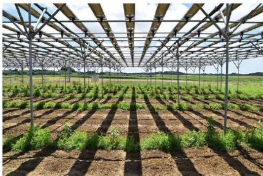
発電設備の外観
