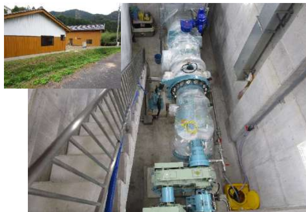
発電施設（奥）と展示室の外観と 水車（流量が多く低落差に適した水車）
