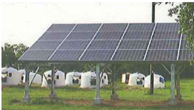
牧場に設置された太陽光パネル
