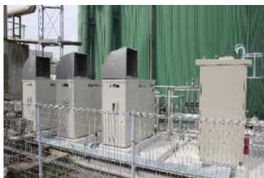
バイオガス発電機
