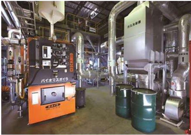
木質バイオマスボイラ
