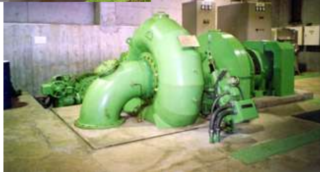
那須野ヶ原発電所
