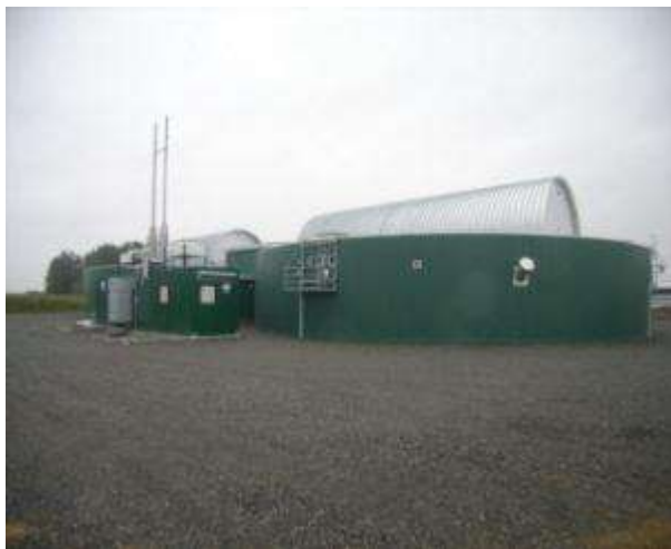
バイオガス発電施設の外観
