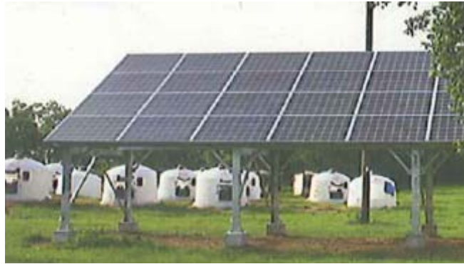
牧場に設置された太陽光パネル
