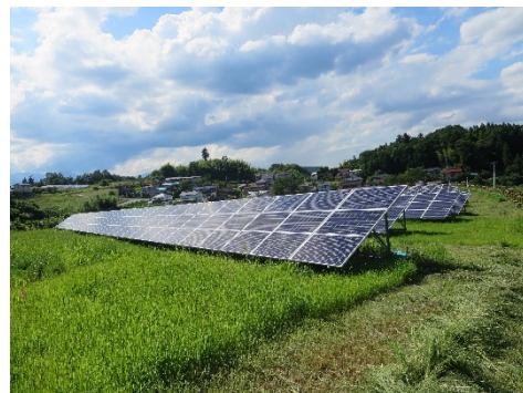
発電施設の外観(二本松)
