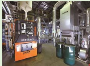
木質バイオマスボイラ
