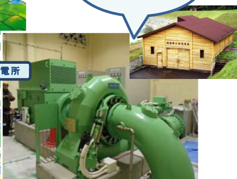
新青木発電所 横軸フランシス水車 最大出力：460kW
