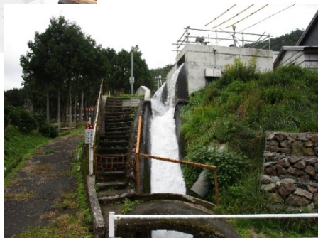
落差 12 m で発電施設内へ流入
