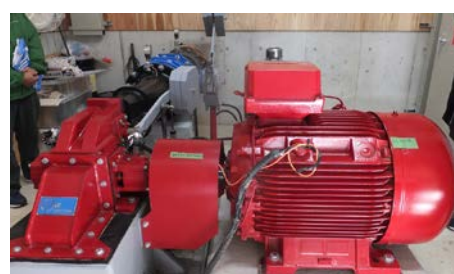
水車と発電機
