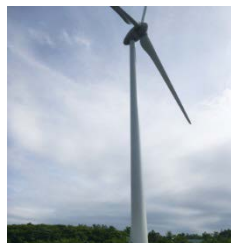
横浜町の既存の風力発電設備
