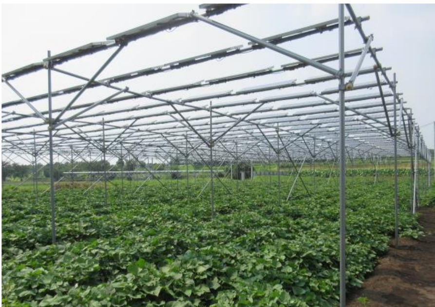
露地の畑の上部にパネルを設置
