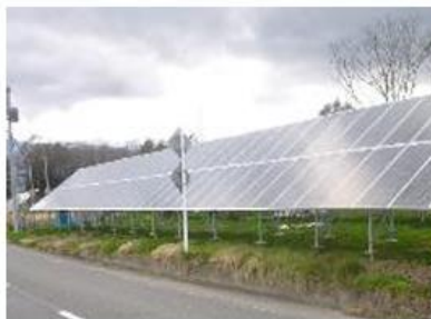
柵塀の設置されない設備
