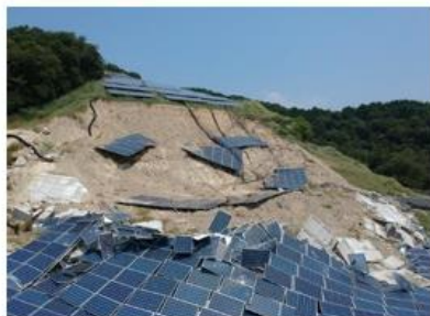
土砂崩れで生じた崩落
