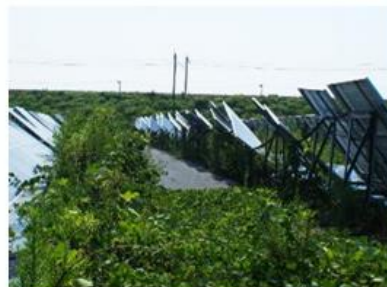
不十分な管理で放置されたパネル
