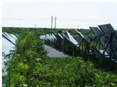
不十分な管理で放置されたパネル
