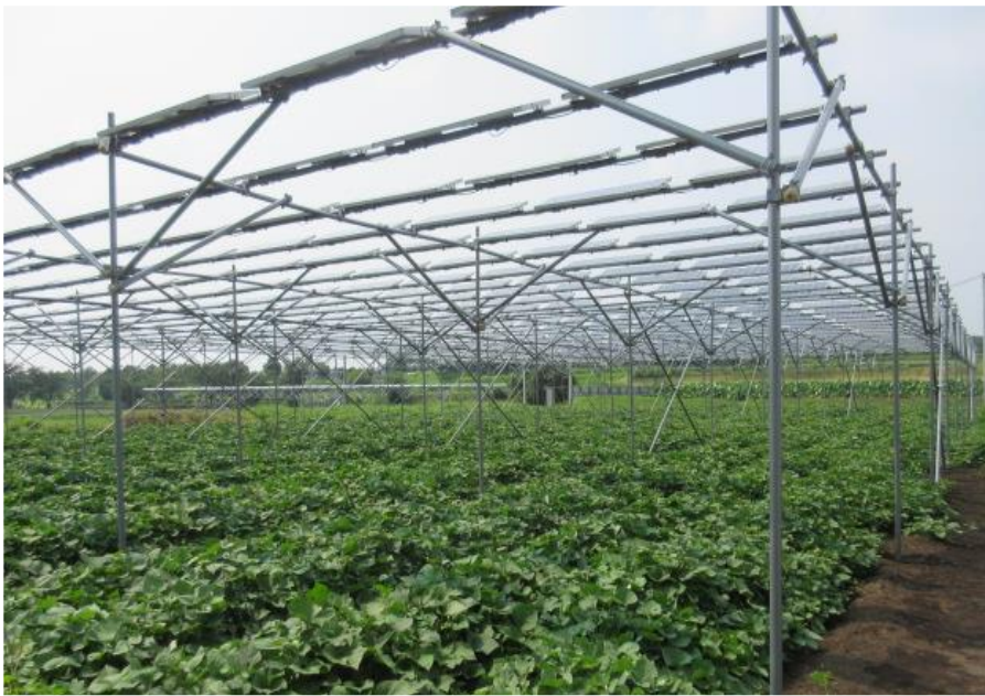
露地の畑の上部にパネルを設置
