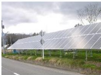
柵塀の設置されない設備
