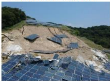
土砂崩れで生じた崩落
