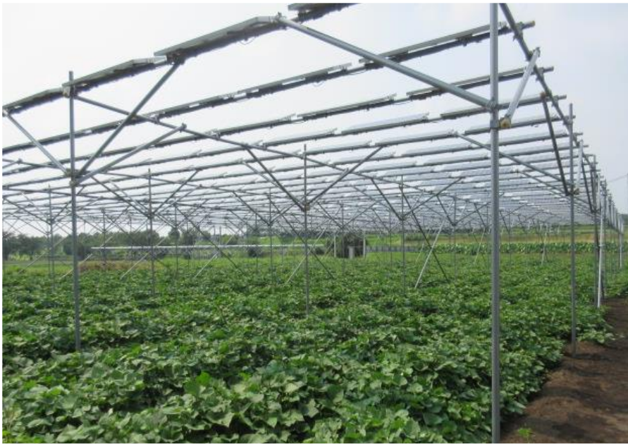
露地の畑の上部にパネルを設置
