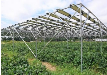
発電設備の外観
