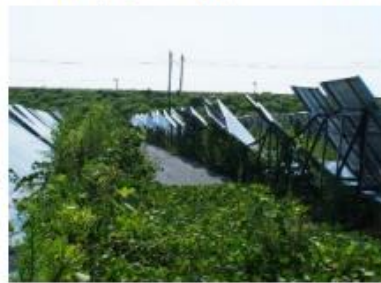
不十分な管理で放置されたパネル
