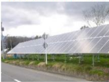
柵の設置されない設備
