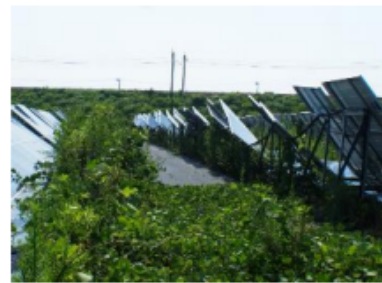
不十分な管理で放置されたパネル
