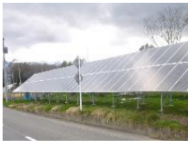
柵塀の設置されない設備
