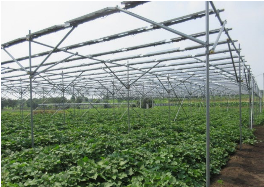
露地の畑の上部にパネルを設置
