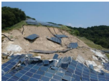
土砂崩れで生じた崩落
