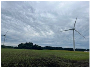
白神ウインドパワー発電所の外観
