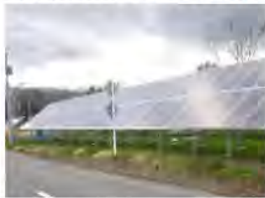
柵塀の設置されない設備
