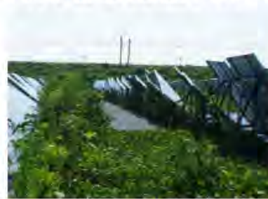
不十分な管理で放置されたパネル
