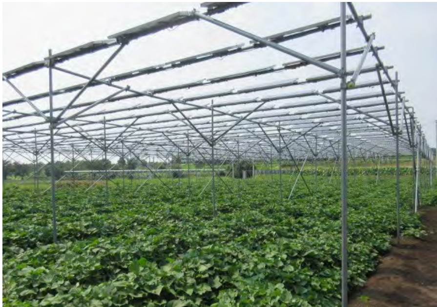
露地の畑の上部にパネルを設置
