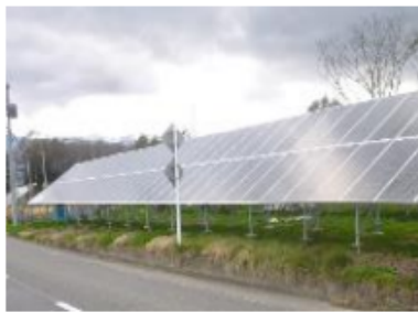
柵塀の設置されない設備
