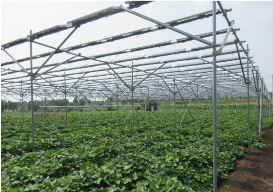
露地の畑の上部にパネルを設置
