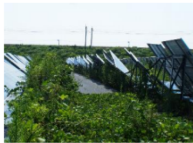
不十分な管理で放置されたパネル
