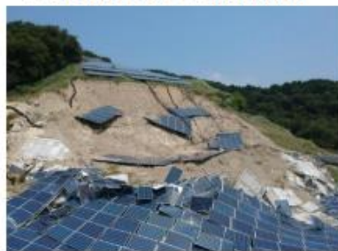
土砂崩れで生じた崩落
