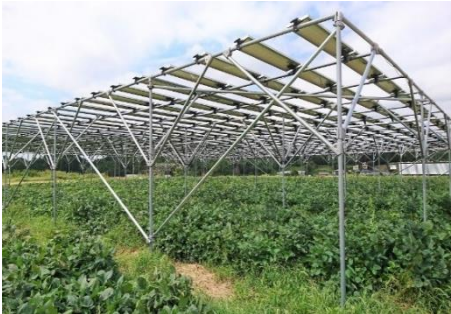
発電設備の外観
