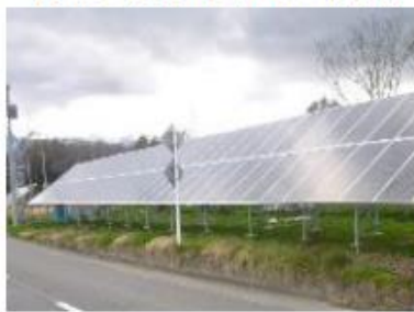
柵塀の設置されない設備
