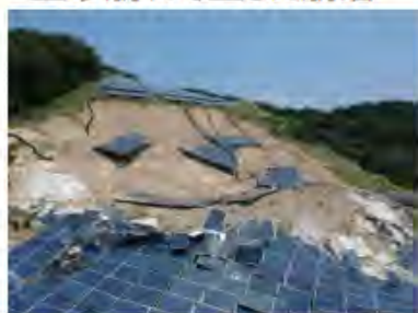
土砂崩れで生じた崩落
