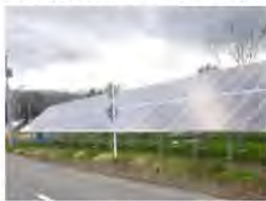
柵塀の設置されない設備
