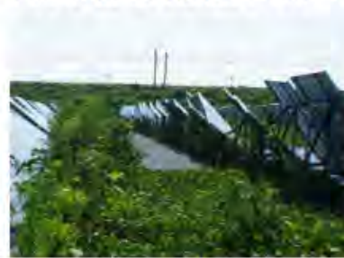
不十分な管理で放置されたパネル
