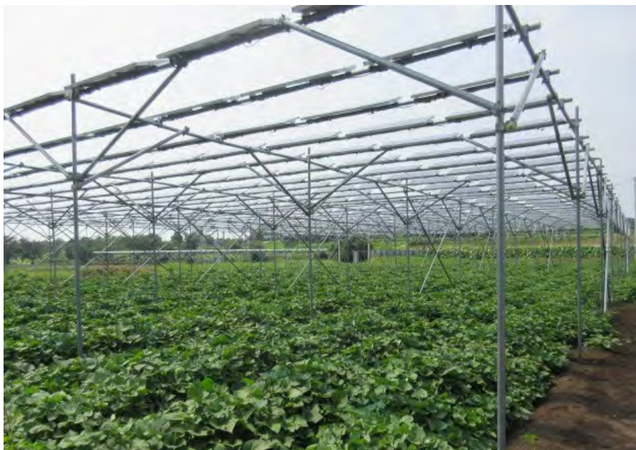
露地の畑の上部にパネルを設置
