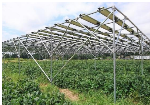
発電設備の外観
