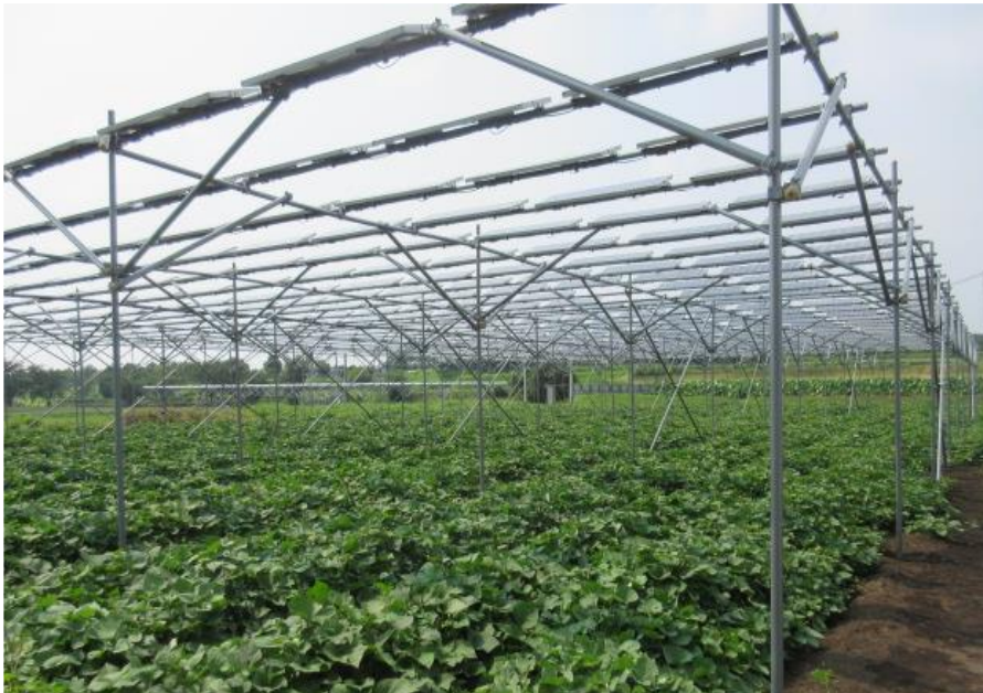
露地の畑の上部にパネルを設置
