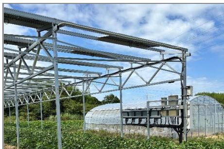
電力の一部をハウスへ共有
