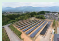
リユース品を使用した発電所
