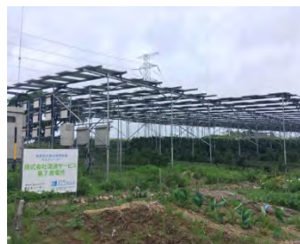
営農型太陽光発電設備
