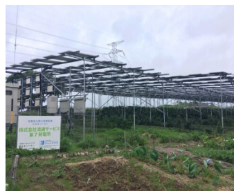
営農型太陽光発電設備
