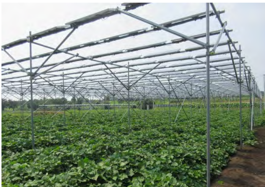
露地の畑の上部にパネルを設置
