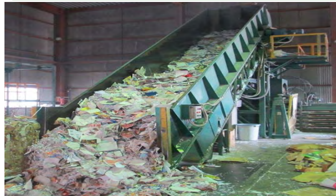
古紙・プラスチック 圧縮梱包設備
