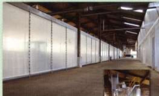
脱臭機内のカーテン・臭気吸引ダクト (工場内は常に陰圧となります)
