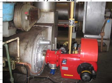
RC工場燃転設備
