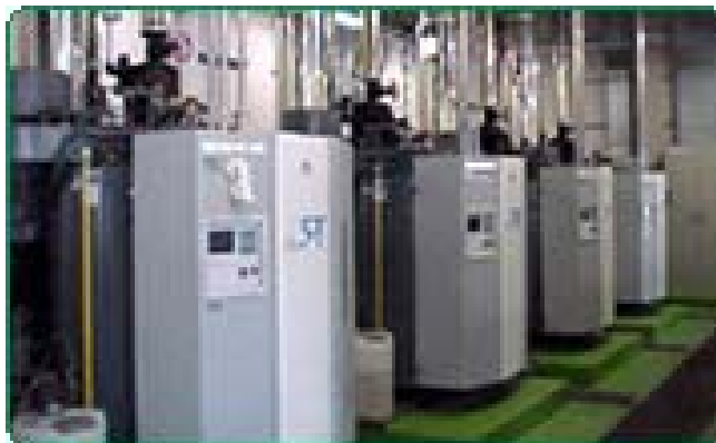
図表 廃食油ボイラー
