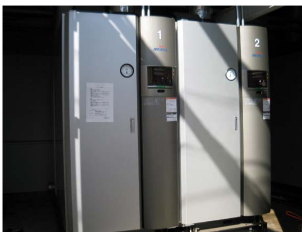
図表 ボイラー(都市ガス)
