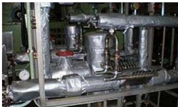
図表 断熱素材で包んだ蒸気配管等
