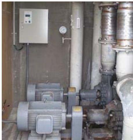
図表 制御盤を取り付けたインバータと駆動モーター
