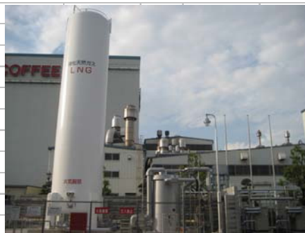
LNG受け入れ設備
