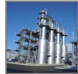
濃縮・蒸留・脱水設備
