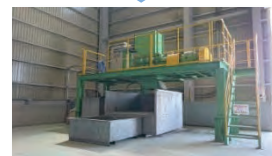
製品廃棄物破碎設備
