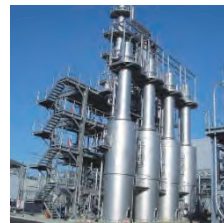
濃縮・蒸留・脱水設備
